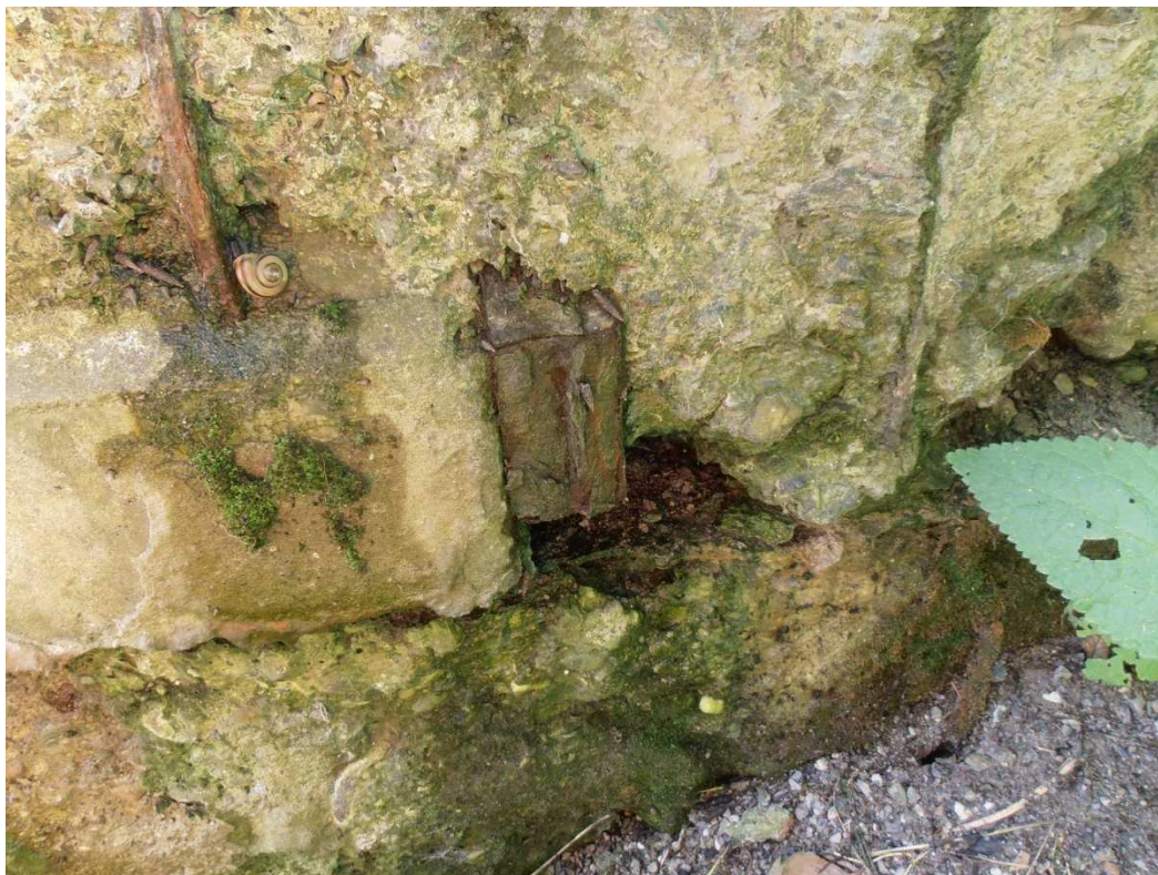
Obnažená a skorodovaná kotva predpätia
