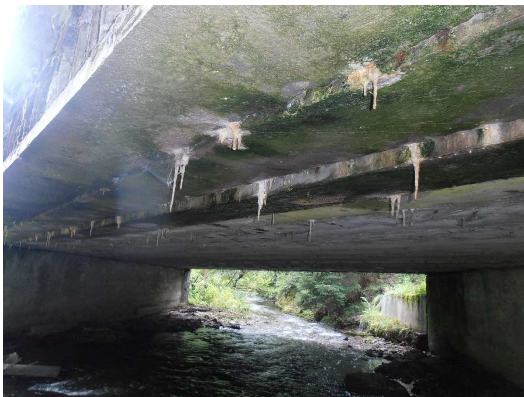
Zdegradovaný betón NK
