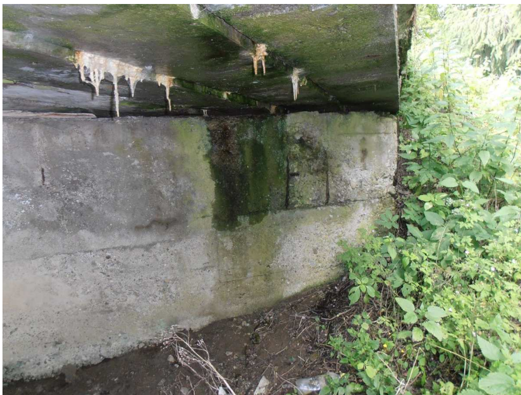
Zatekanie NK a opory 1
