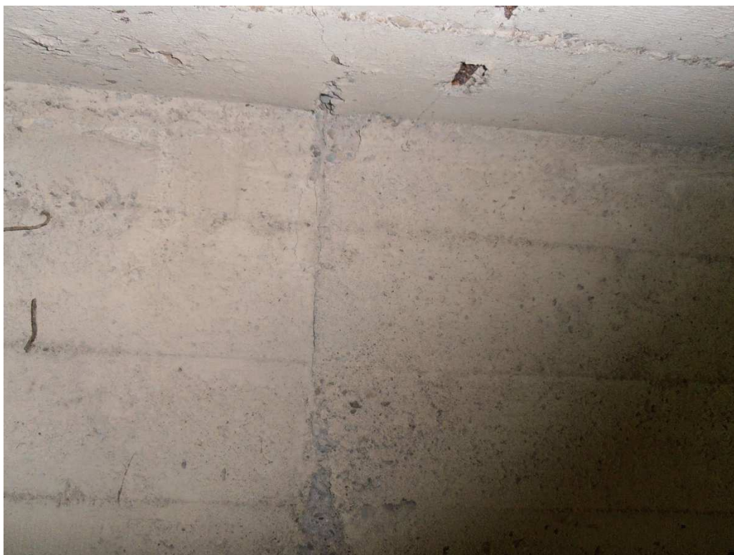
Zvisle trhliny v betóne opôr
