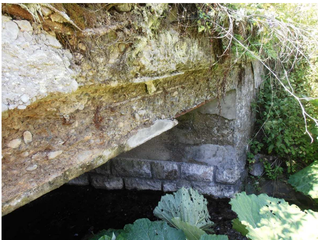
Strana výtoku – zdegradované betóny rímsy a NK
