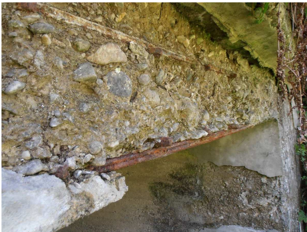
Strana výtoku – zdegradované betóny rímasy a NK
