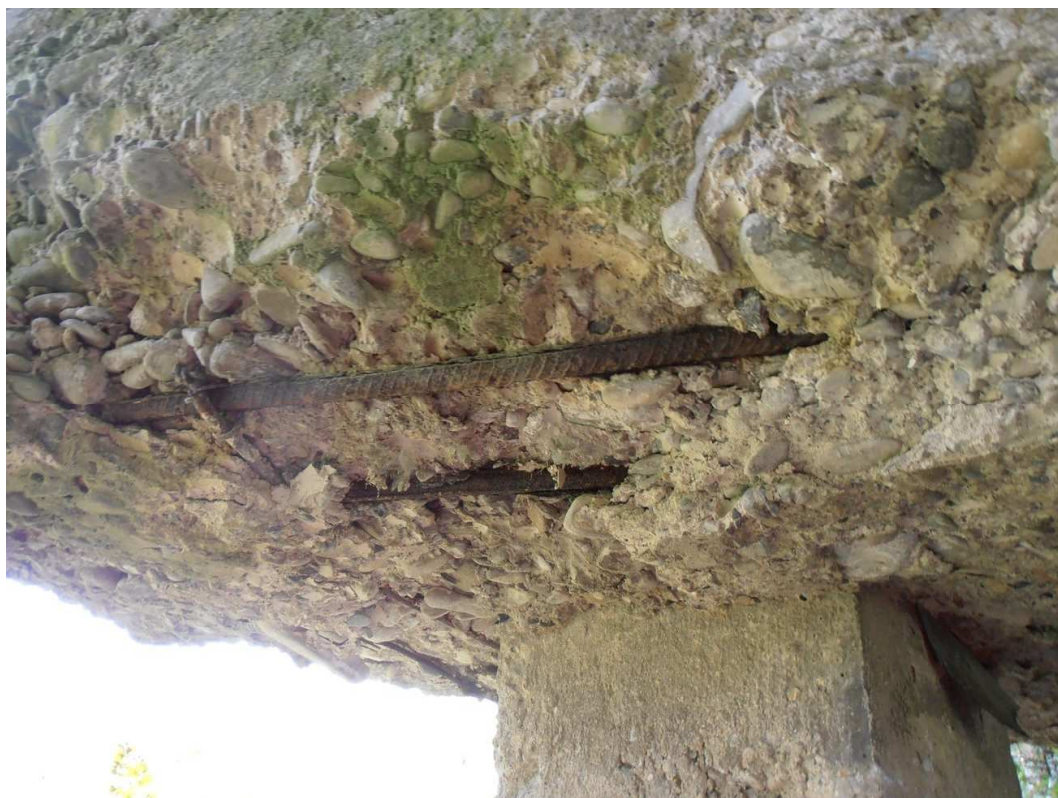
Poškodenie UP piliera
