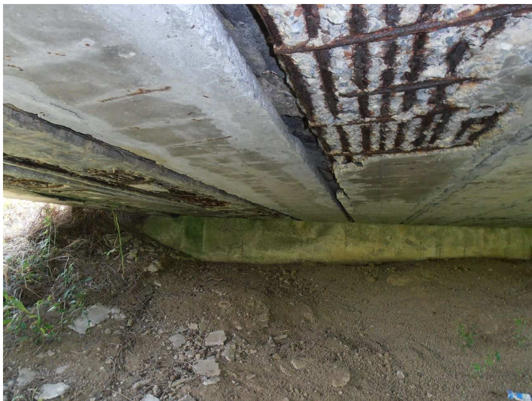
Korózia výstuže nosníkov
