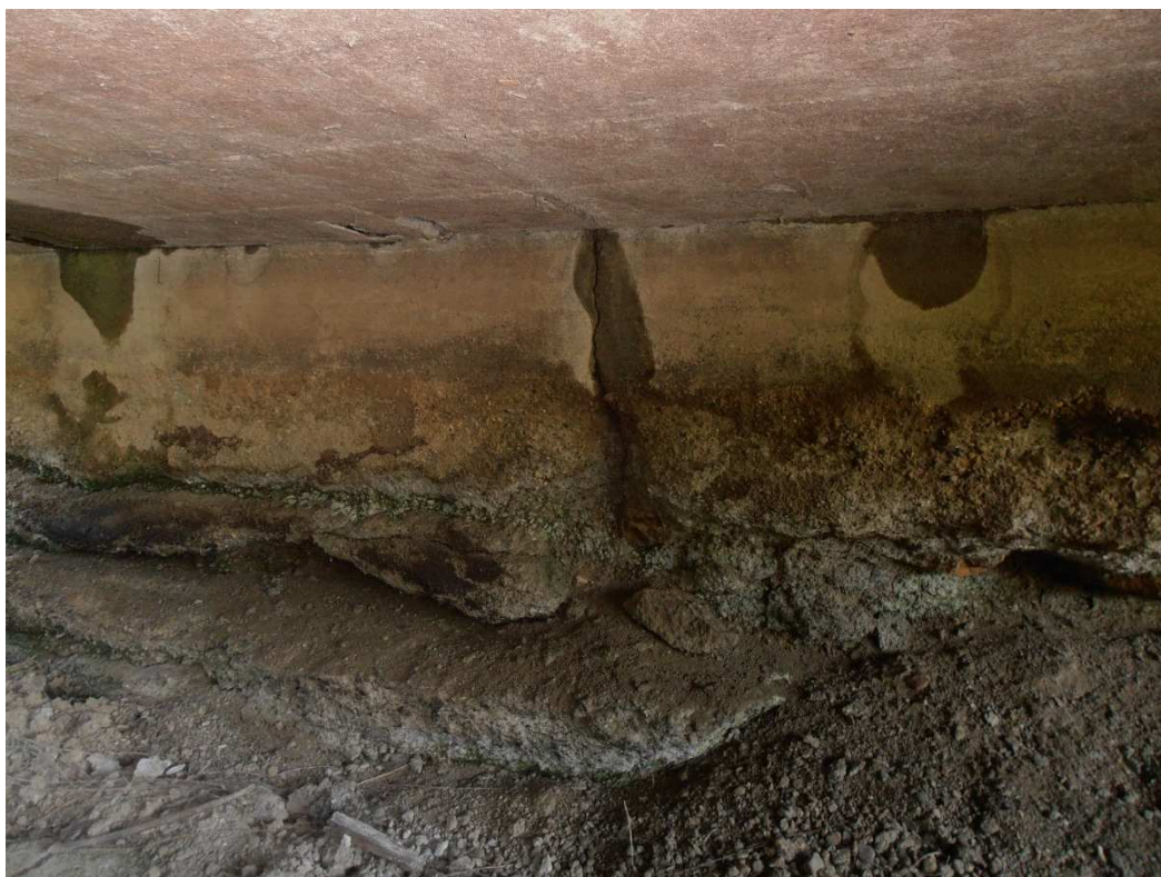
Rozpad betónov opory 2
