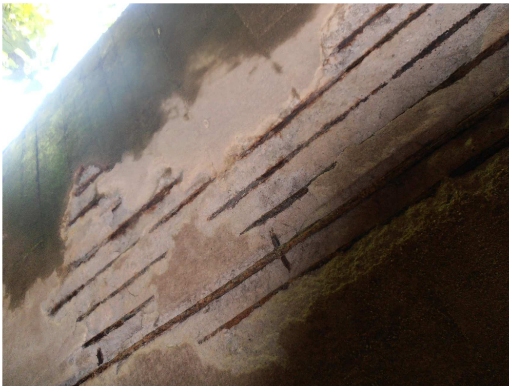
Odokrytá nosná výstuž - zatekanie
