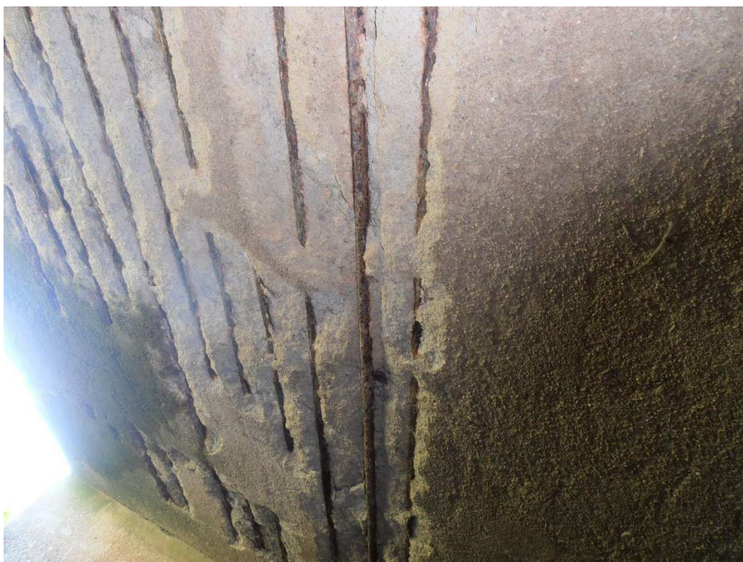
Odokrytá nosná výstuž
