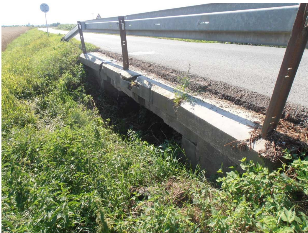
Pohľad na poškodenú rímsu
