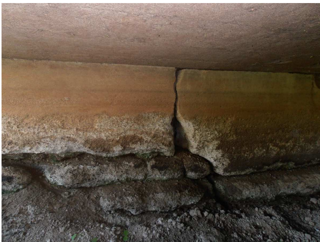
Trhlina v opora č. 1
