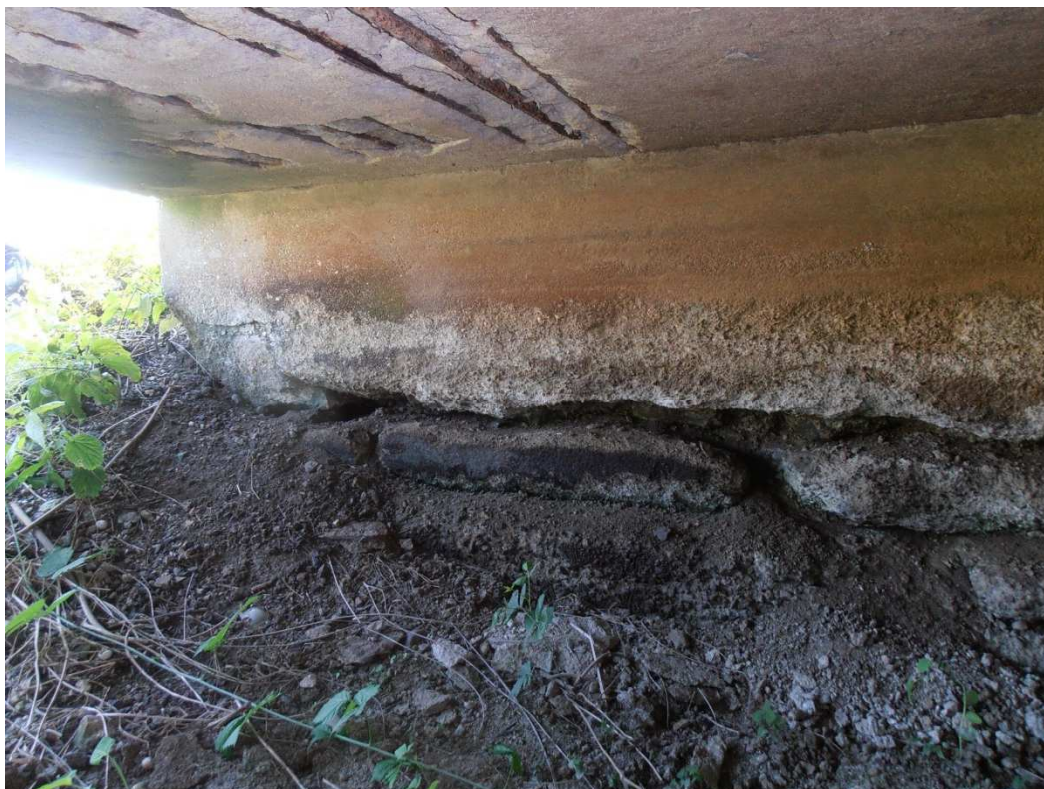
Rozpad betónov opory 1
