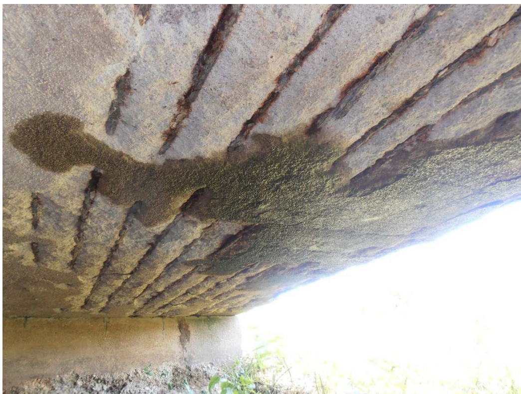
Odokrytá nosná výstuž - zatekanie
