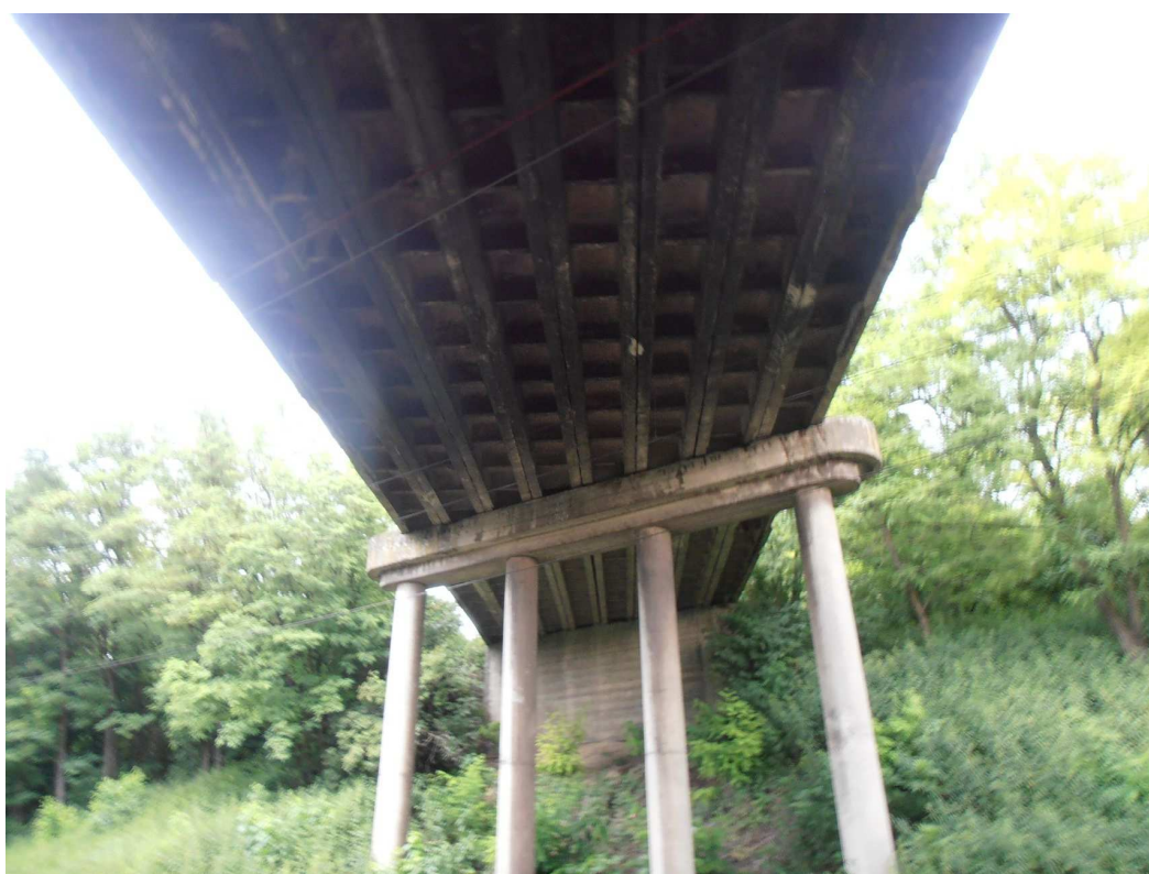
Nosná konštrukcia – znečistenie výfukovými plynmi
