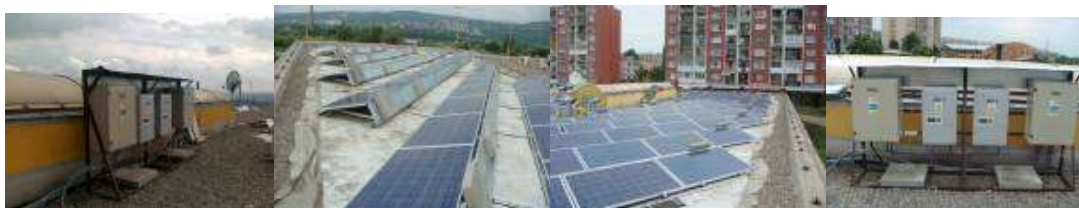
Fotovoltaické panely FVZ Ťahanovce/Košice
