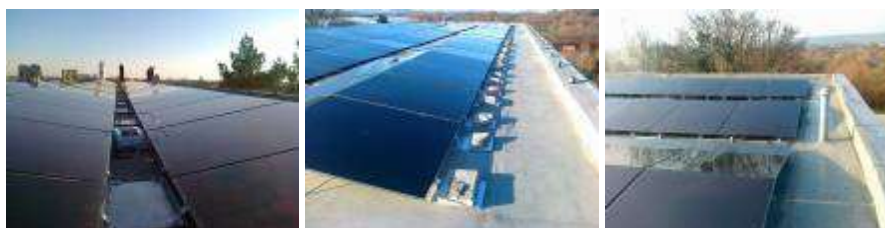
Fotovoltaické panely FVZ na streche Administratívnej budovy v Michalovciach 31kW
