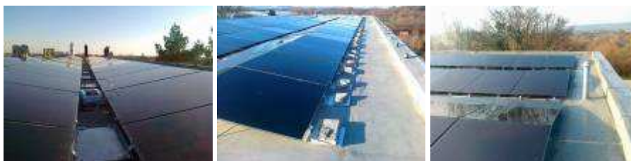
Obr. 29 Fotovoltaické panely FVZ na streche Administratívnej budovy v Michalovciach 31kW ( http://www.energodata-ke.sk/renewable-energy )
