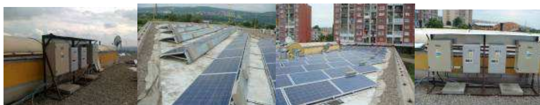
Obr. 30 Fotovoltaické panely FVZ Ťahanovce/Košice ( http://www.energodata-ke.sk/renewable-energy )
