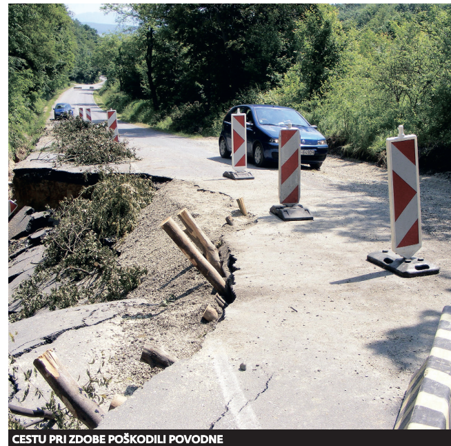
CESTU PRI ZDOBE POŠKODILI POVODNE
